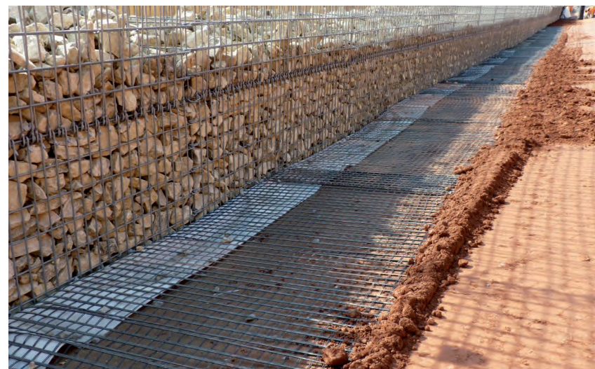
Mur en gabions avec nappes de renforcement (A3 au niveau de la vallée Haseltal, Allemagne)
