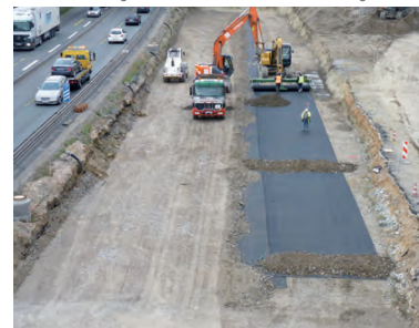
Mise en œuvre d'un système parachute anti-effondrement (nœud autoroutier ouest de Bochum, A 52, Allemagne)
